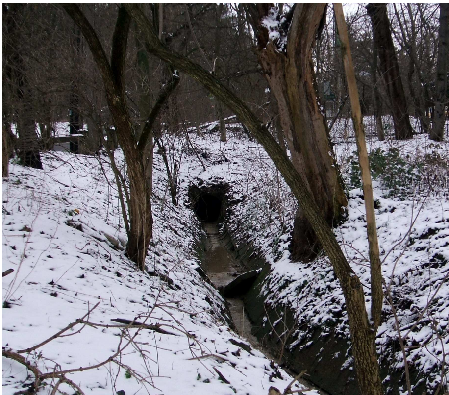
1. kép. A Szép-völgy felső szakaszán elhelyezkedő csapadékelvezető-csatorna Fenyőgyöngye alatti kifolyója
